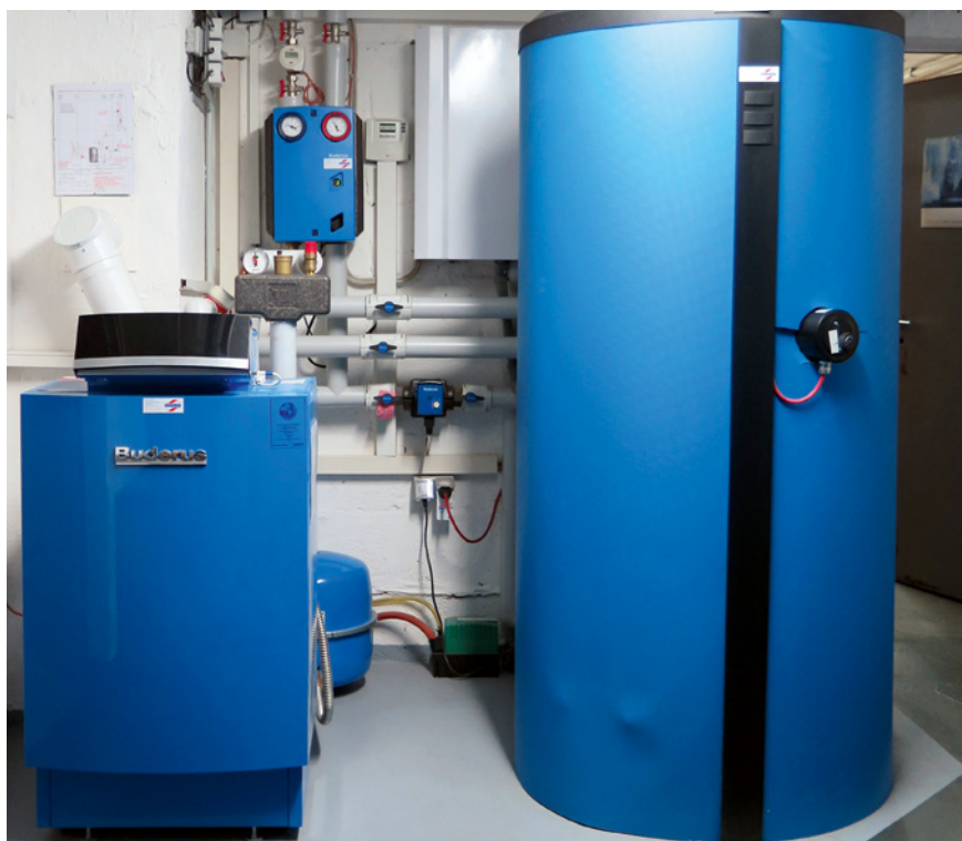
Der Buderus Öl-Brennwertkessel Logano plus GB145 wird im Rahmen des Modellvorhabens zu 50 Prozent mit einem neuartigen Heizöl mit wesentlich geringeren CO 2 -Emissionen betrieben.
